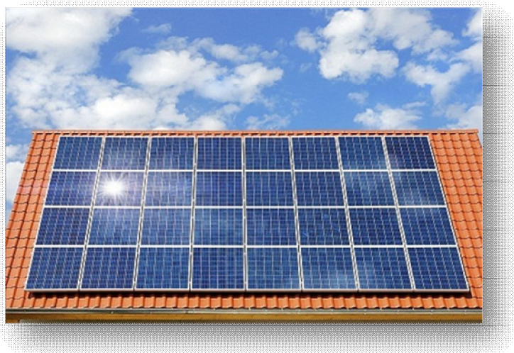
Σχήμα 5.10: Φωτοβολταϊκά πλαίσια σε στέγη
