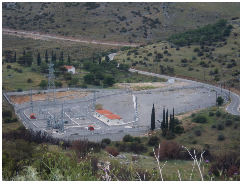
Εικόνα 5: Υποσταθμός ΔΕΗ Βουνιχώρας (Αρχείο ομάδας μελέτης)
